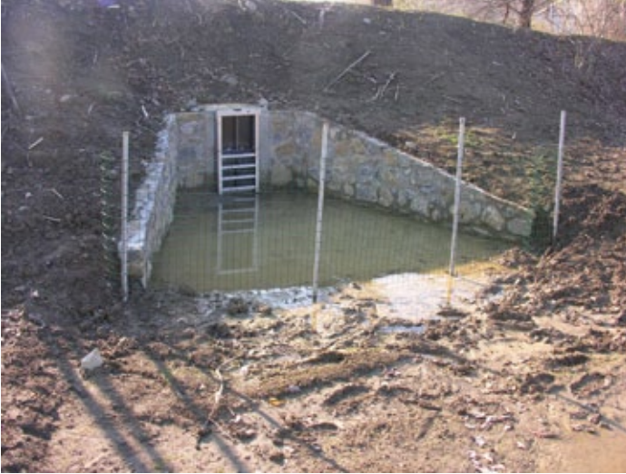
Fig. 39 – Veduta della paratoia di restituzione.
